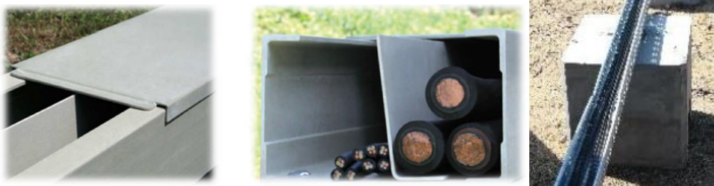
Illustration des chemins de câbles : à gauche le chemin de câble muni de son couvercle, au centre ouvert vue de l'intérieur et à droite un plot en béton
