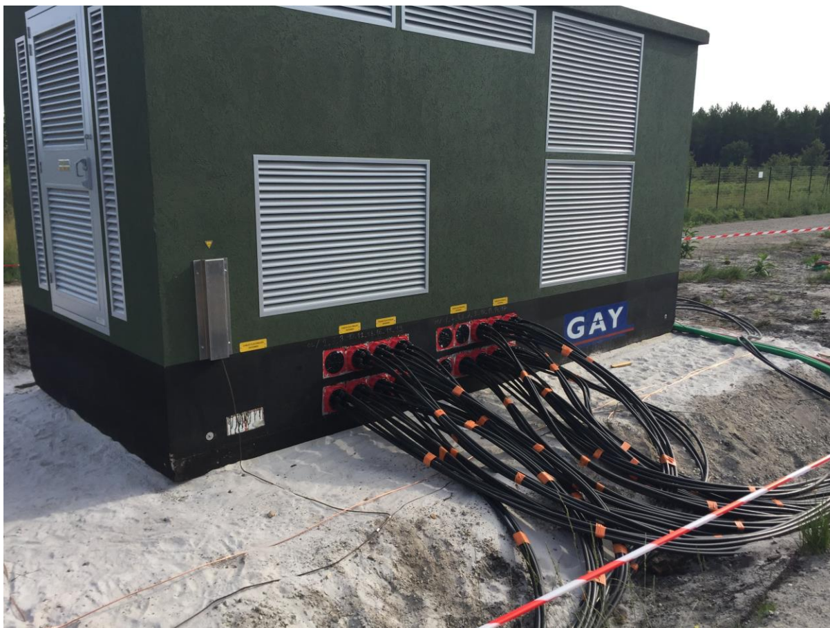
Figure 19 : Exemple de poste de transformation (Source : Eiffage Energie)
