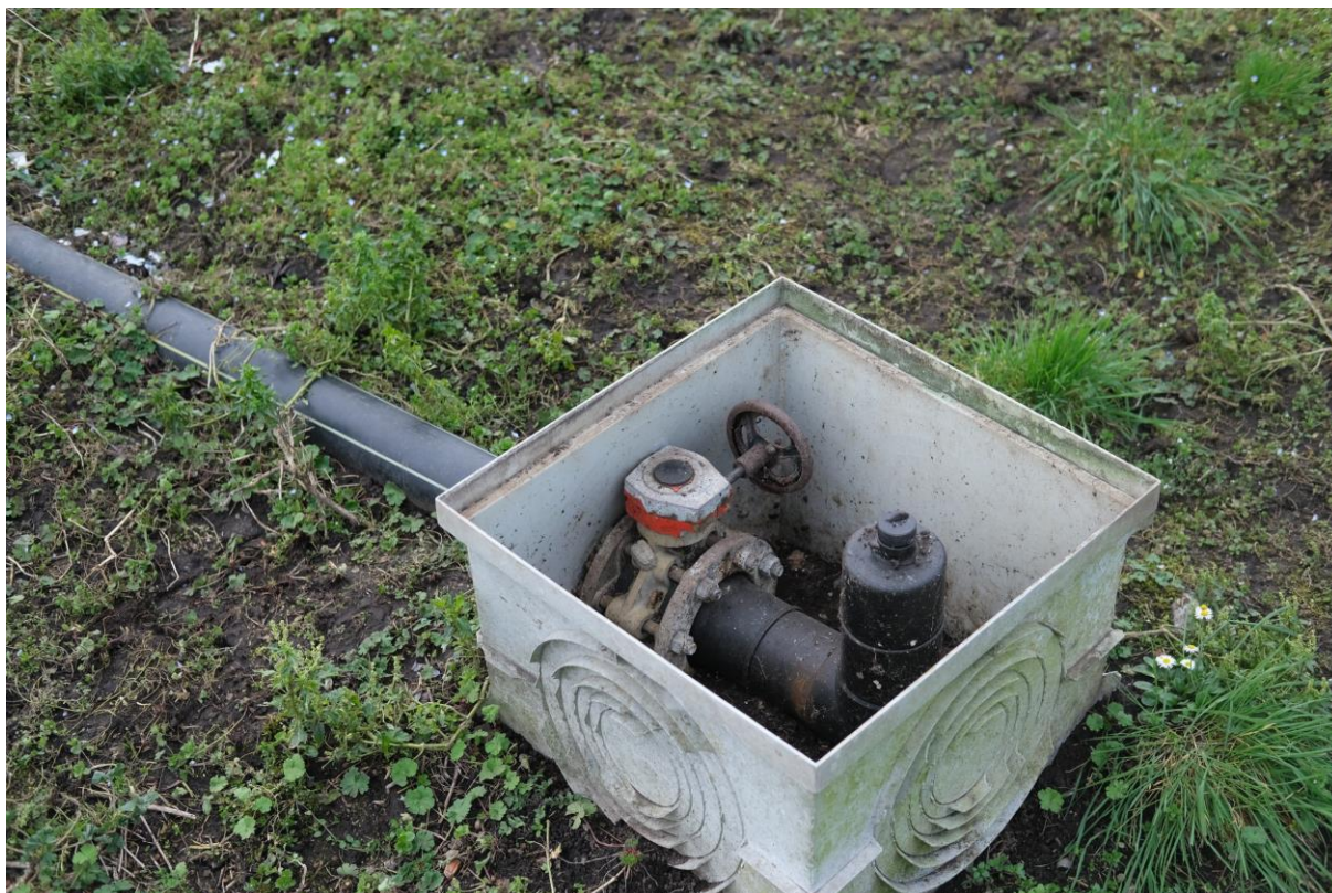
Figure 30 : Conduite de biogaz externe présente sur le site (Source : CAPBP)
