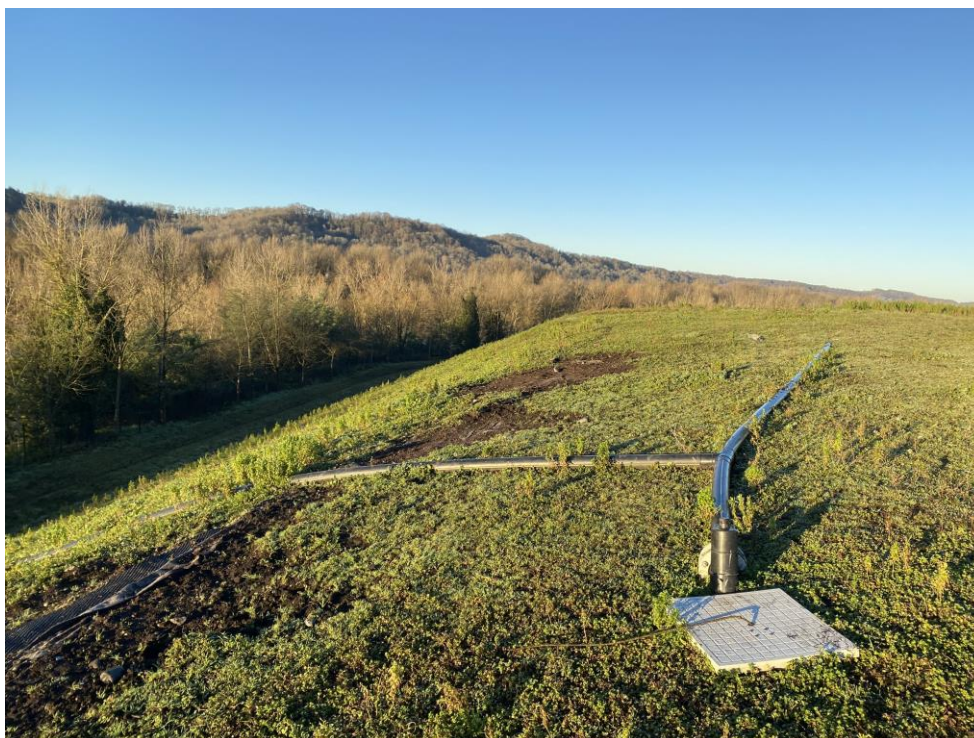
Figure 56 : Canalisation de biogaz parcourant le périmètre d'étude © ETEN Environnement
